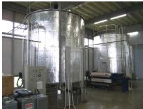
施設内BDFプラント
