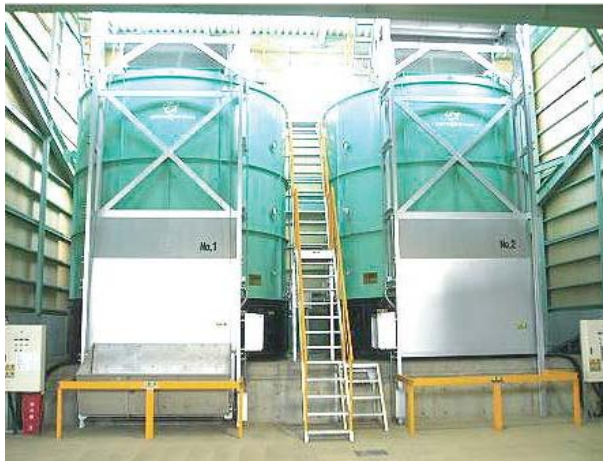
食品残さ発酵槽（2基）
