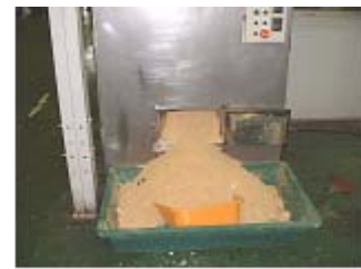
回収された生ごみは、大型生ごみ処理機で高速発酵処理します。
