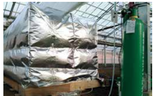
高濃度炭酸ガス処理設備 (簡易水封式)
